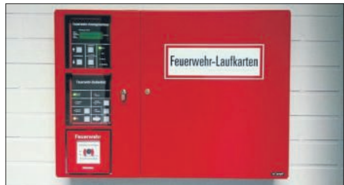
Über das Feuerwehrbedienfeld erhalten die Brandschützer detailliertere Informationen bei einem BMA-Alarm (Bildquelle: FF Geislingen)
