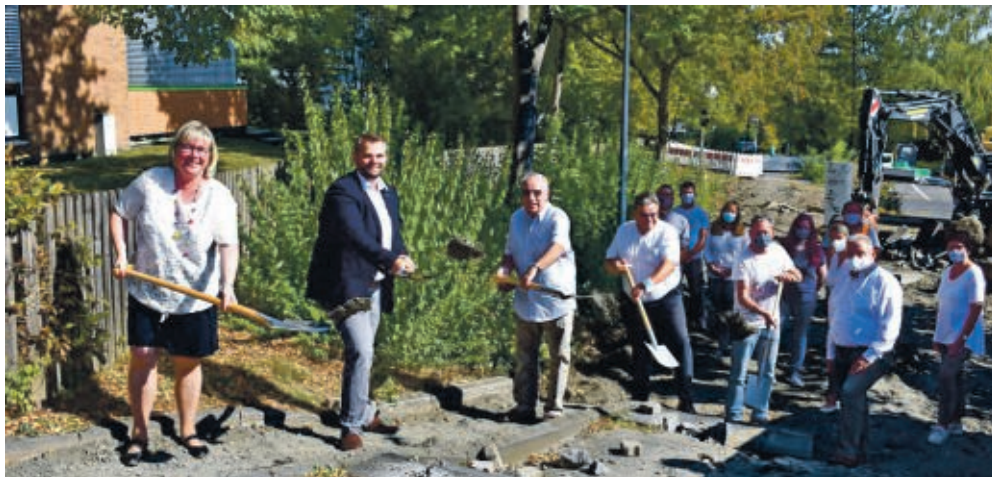
Der Spatenstich zum Start des Wegeumbaus war ein weiterer Meilenstein im Wohngebiet Baunsberg.
