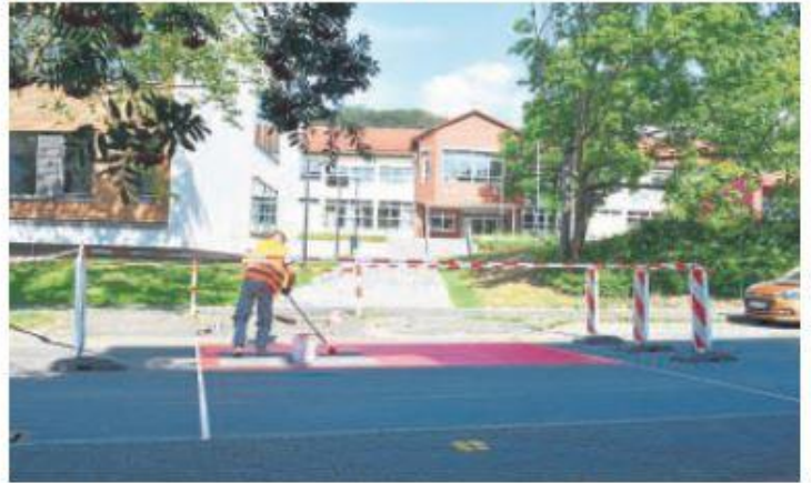
Der Querungsbereich vor der Schule wurde rot markiert.
